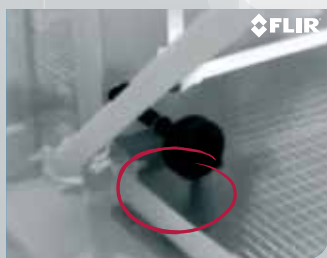
ガス漏れしている圧力計
