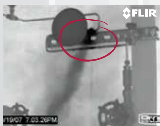
製造施設からのガス漏れ
