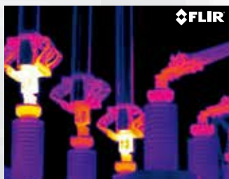
高圧設備の赤外線検査
